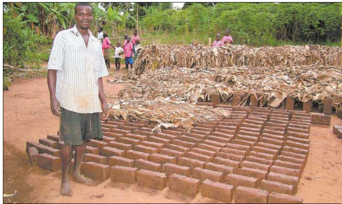
Selbst vor Ort gebrannte Ziegel dienen dem Aufbau eines Schulgebäudes im ugandischen Dorf Kimanto. Rund 800 Kinder werden das zweiklassige Schulgebäude besuchen, wenn es Mitte Juli eingeweiht wird.
